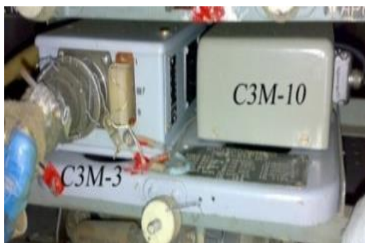
Фото 28. Блок сигнализации СЗМ-3 и блок питания СЗМ-10;
