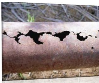
6.1-сурет. Коррозияға ұшыраған құбыр
